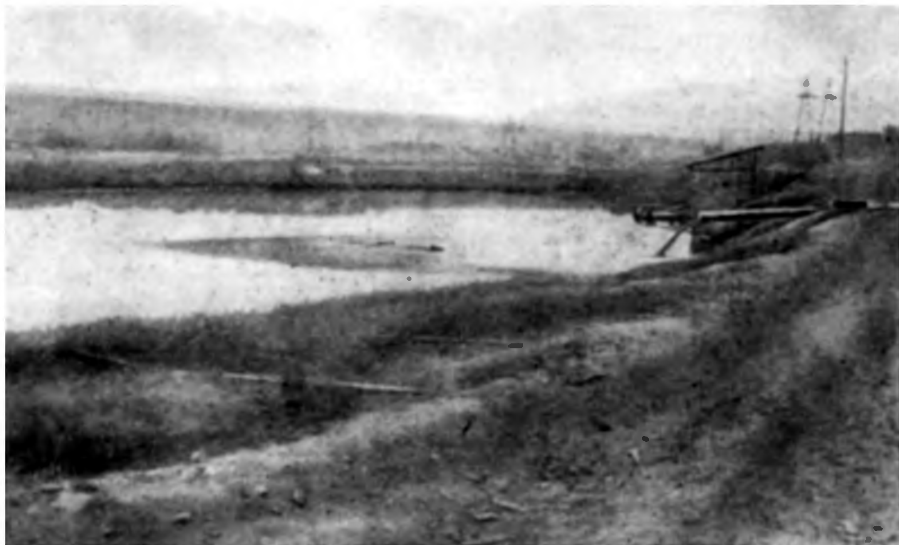
Рис. 38. Вид иловых площадок, превратившихся в «иловую яму»
